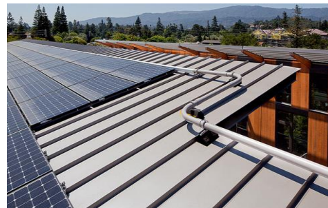
شكل (5) الالواح الشمسية على سطح المبنى (7) .
